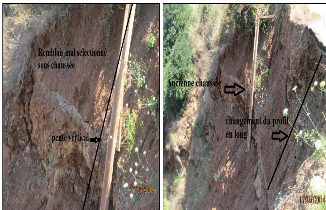
Figure IV.21. Principaux facteurs déstabilisateurs du talus au niveau du PK 23+00
