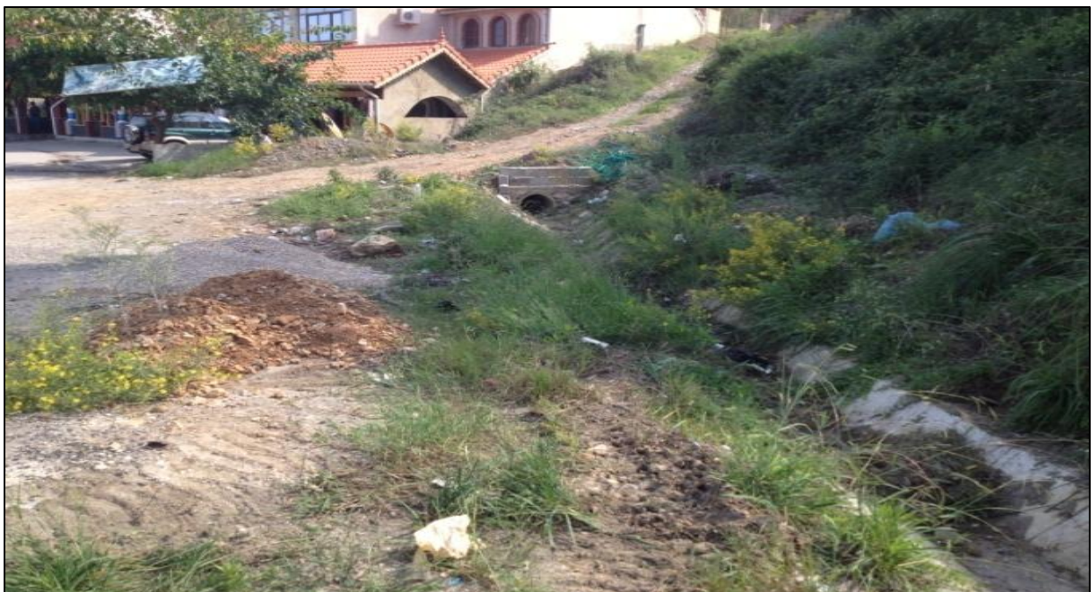
Figure IV.27. Caniveau et buse mal entretenues
