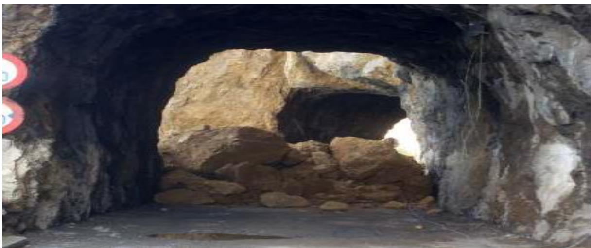
Figure IV.18. Eboulement rocheux à l'entrée de la grotte merveilleuse (2009)
