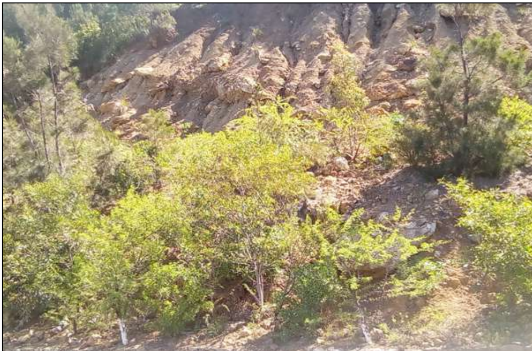
Figure II.9. Eboulis de pentes emballé dans des produits argileux de néo formation au PK 38+250
