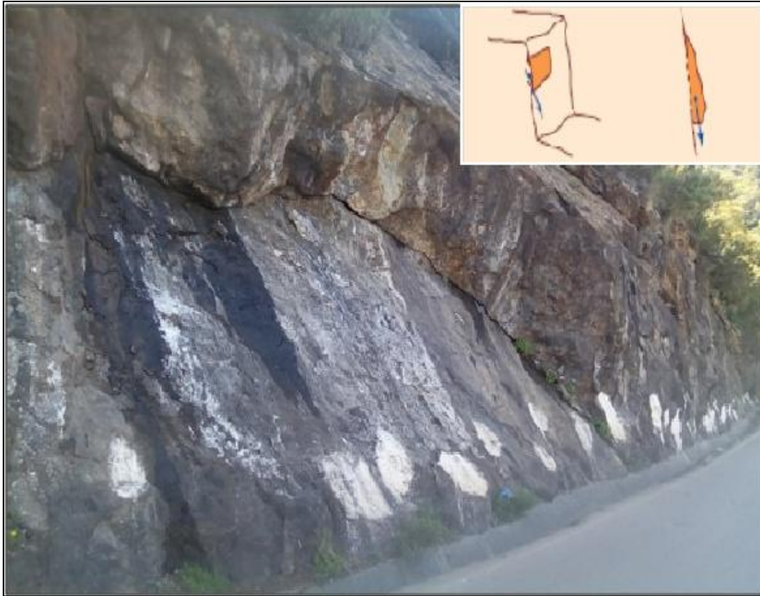
Figure IV.10. Rupture d'écaille en paroi
