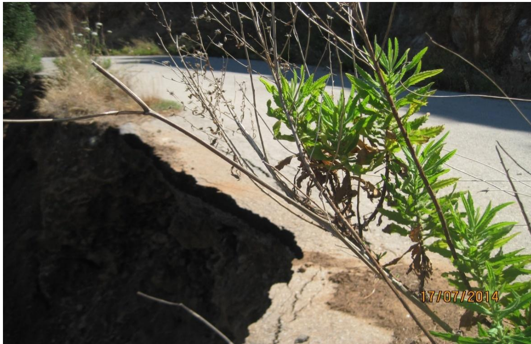
Figure IV.20. Effondrement de la chaussée au PK 23+00
