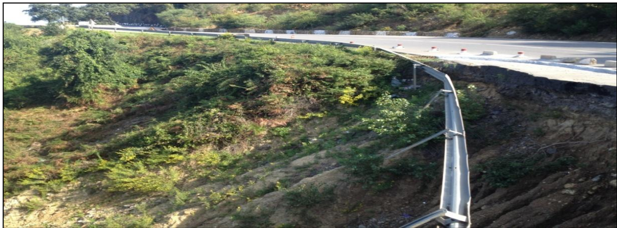
Figure IV.16. Effondrement de la partie droite de la chaussée
