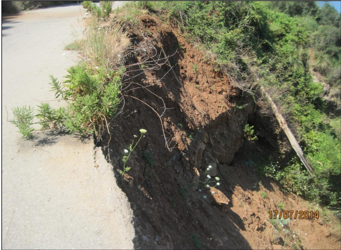
Figure IV.23. Effondrement de la chaussée au PK 22+600
