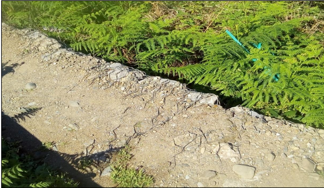
Figure IV.4. Dégradation au niveau des gabionnages (partie aval du talus)
